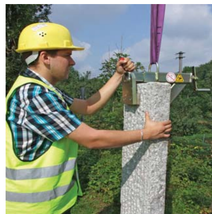
Stelen/Palisaden werden dicht an dicht versetzt. Mit der Handkurbel wird der Stelensetzer gelöst
